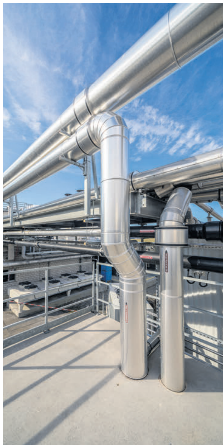
Durch diese Rohre fiesst Biogas. Cleantech Solutions will weitere solche umweltfreundliche Projekte fördern.
