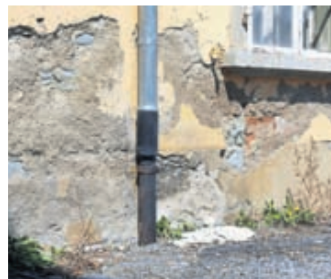
... das Mauerwerk bröckelt.
