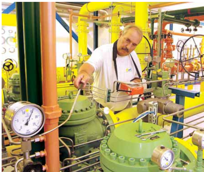
Druckregulierung und Speicherung in der Erdgas-Übergabestation Thorenberg von «ewl energie wasser luzern».
