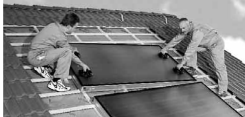
Die ideale Kombination: Ölheizung und Solaranlage; dank standardisierten Komponenten ist die Montage sehr einfach.
