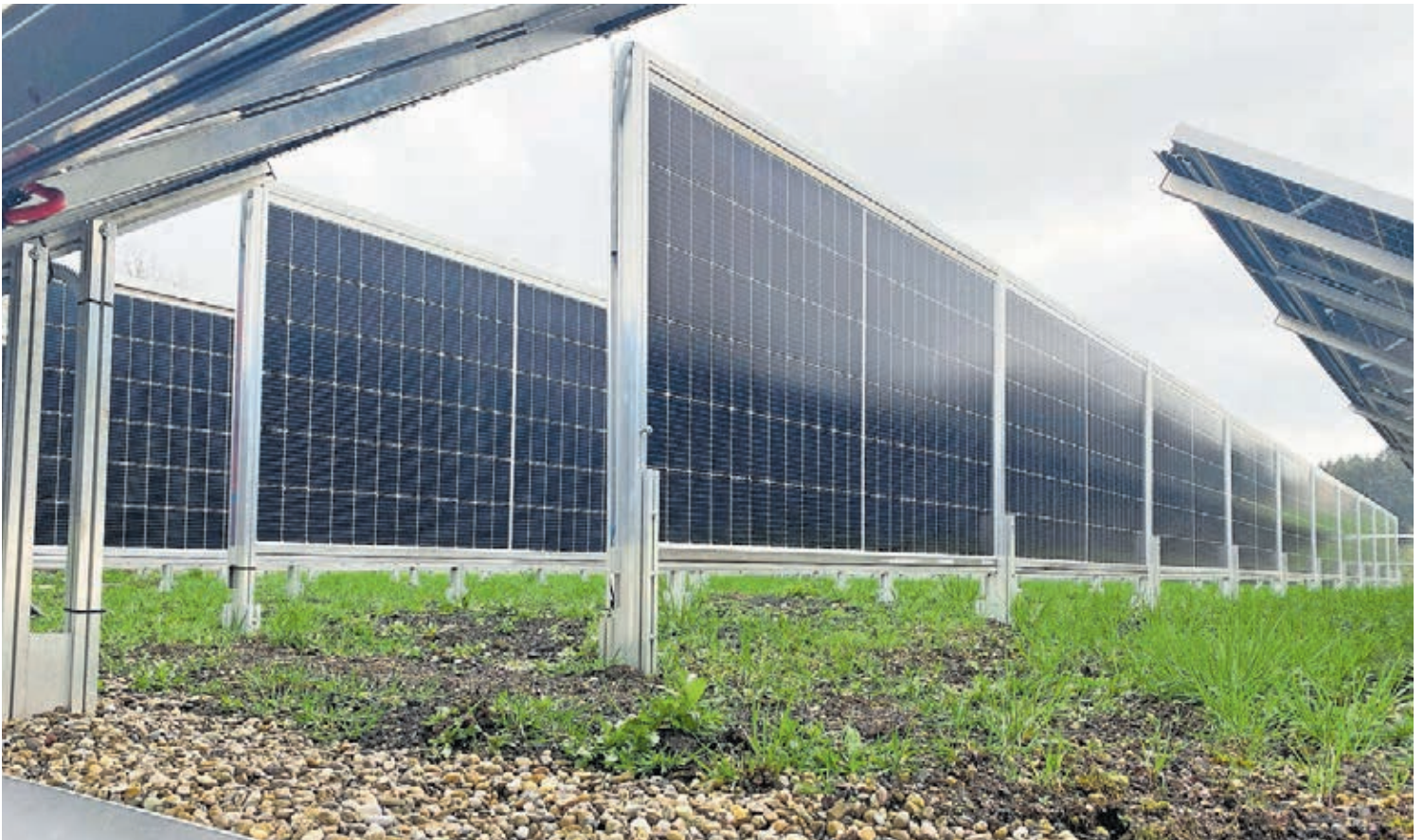
Diese Solaranlage mit vertikalen Panels steht auf einem Dach der Neuen Napfmilch AG in Hergiswil bei Willisau.
