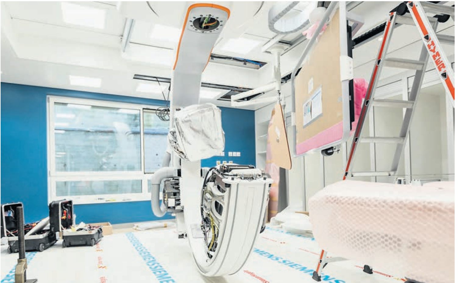
Bea Keller und ihr Team freuen sich auf die hochmoderne Angiographie-Anlage im Trakt G (Teilprojekt vom Gesamtbauprojekt «ANNaplus»), die u. a. für die interventionelle Angiographie eingesetzt wird.
